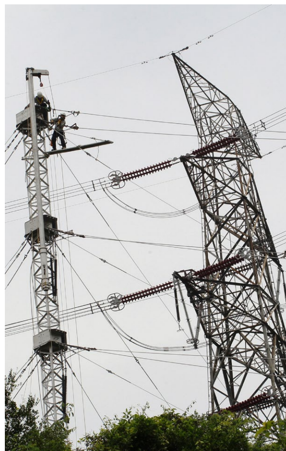
架空電纜技術人員正在約 70 呎高的臨時電塔上接駁導線。建造一個臨時電塔需時十多天，較重建傳統輸電塔快十多倍。
