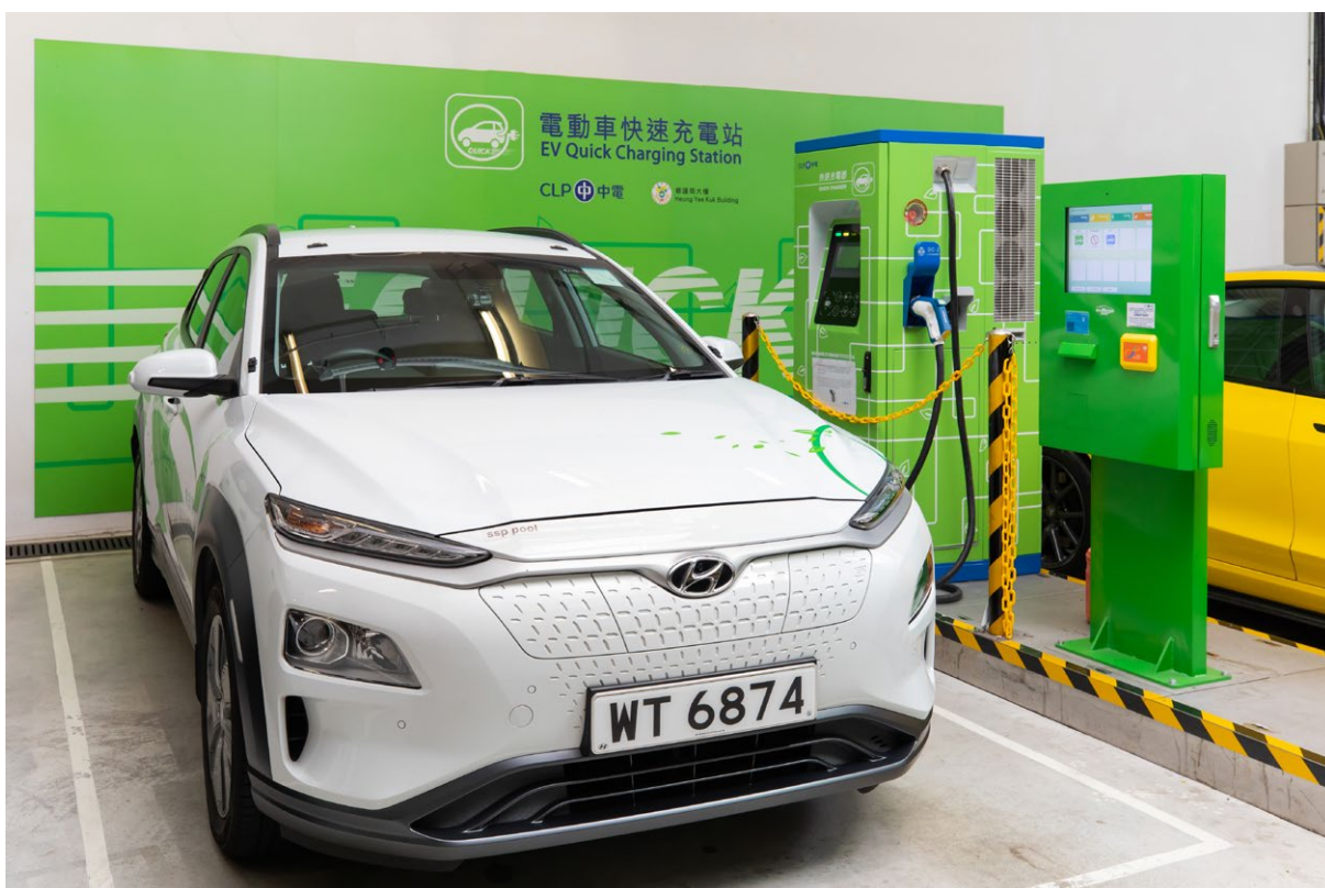
中電電動車充電站
