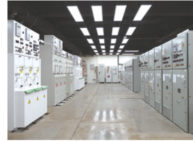
高壓電力系統培訓中心是由兩個相聯的一萬一千伏特帶電環形電網組成。 High Voltage Training Centre with two interconnected and energised 11kV ring circuits.
