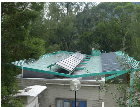
建於建築物天台的 太陽能發電系統
